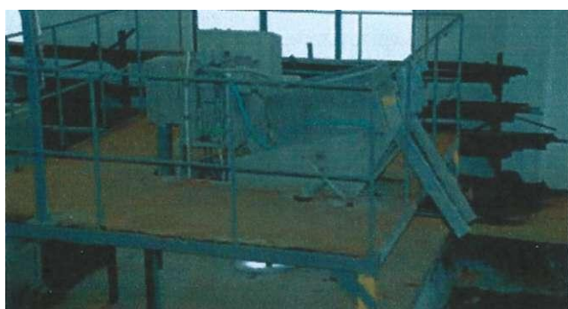
Рис. 3. Шнековый дегидрататор обезвоживания отходов очистки
